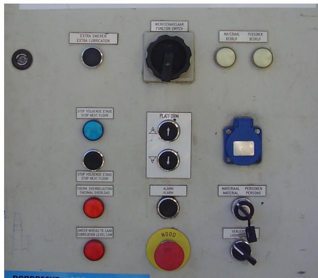
bedieningskast op lift
